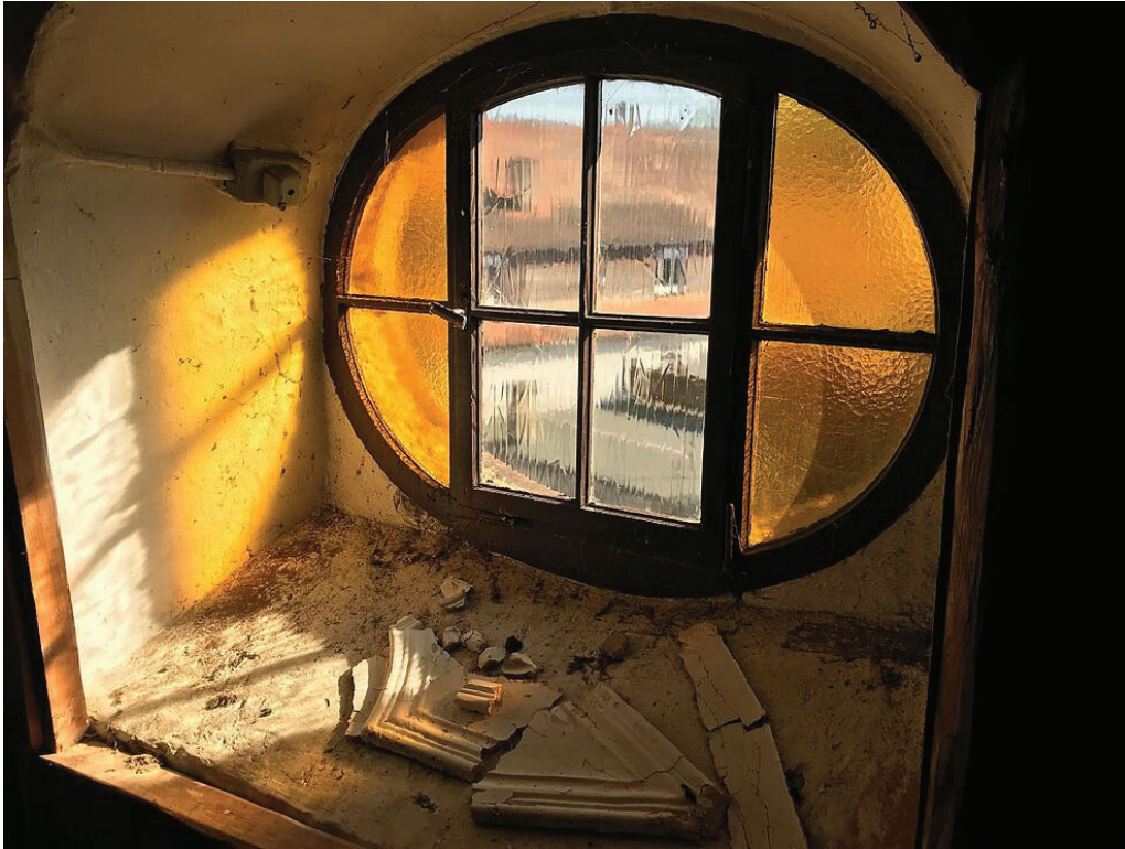
Vier ovale Fenster befinden sich auf der Süd- und Nordseite des Kirchenschiffes. Auf der Südseite oben die Jahrzahl 1733 (Aufstockung).
