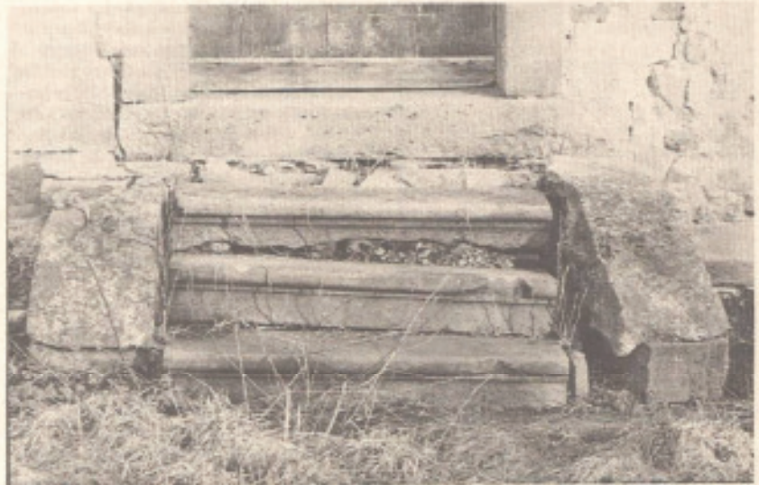
AN DER TREPPE zur alten Kirche haben sich die Stufen gesetzt. Gras und Kräuter wachsen aus den Fugen.
